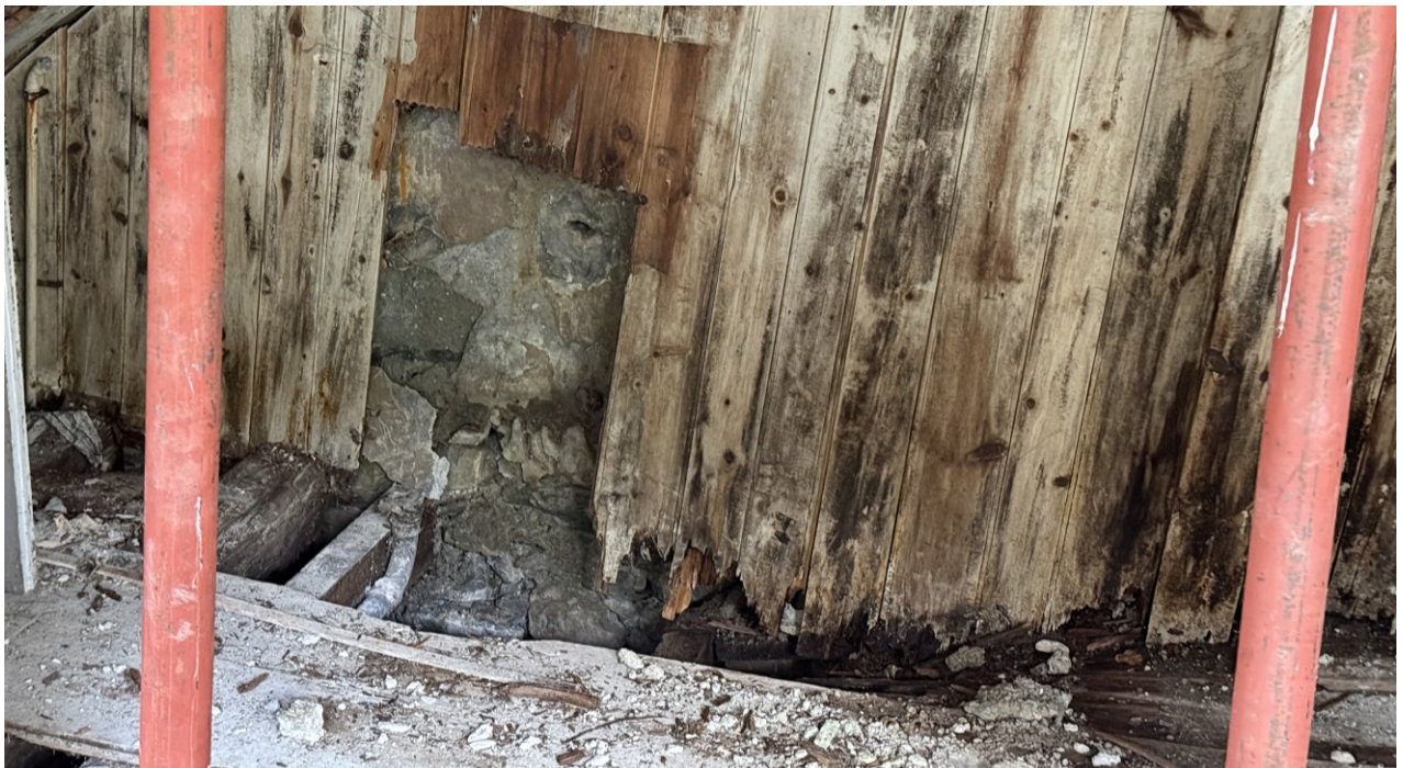
Abb. 12: Abgefaltete Bretter am Fuss einer Wandverkleidung
