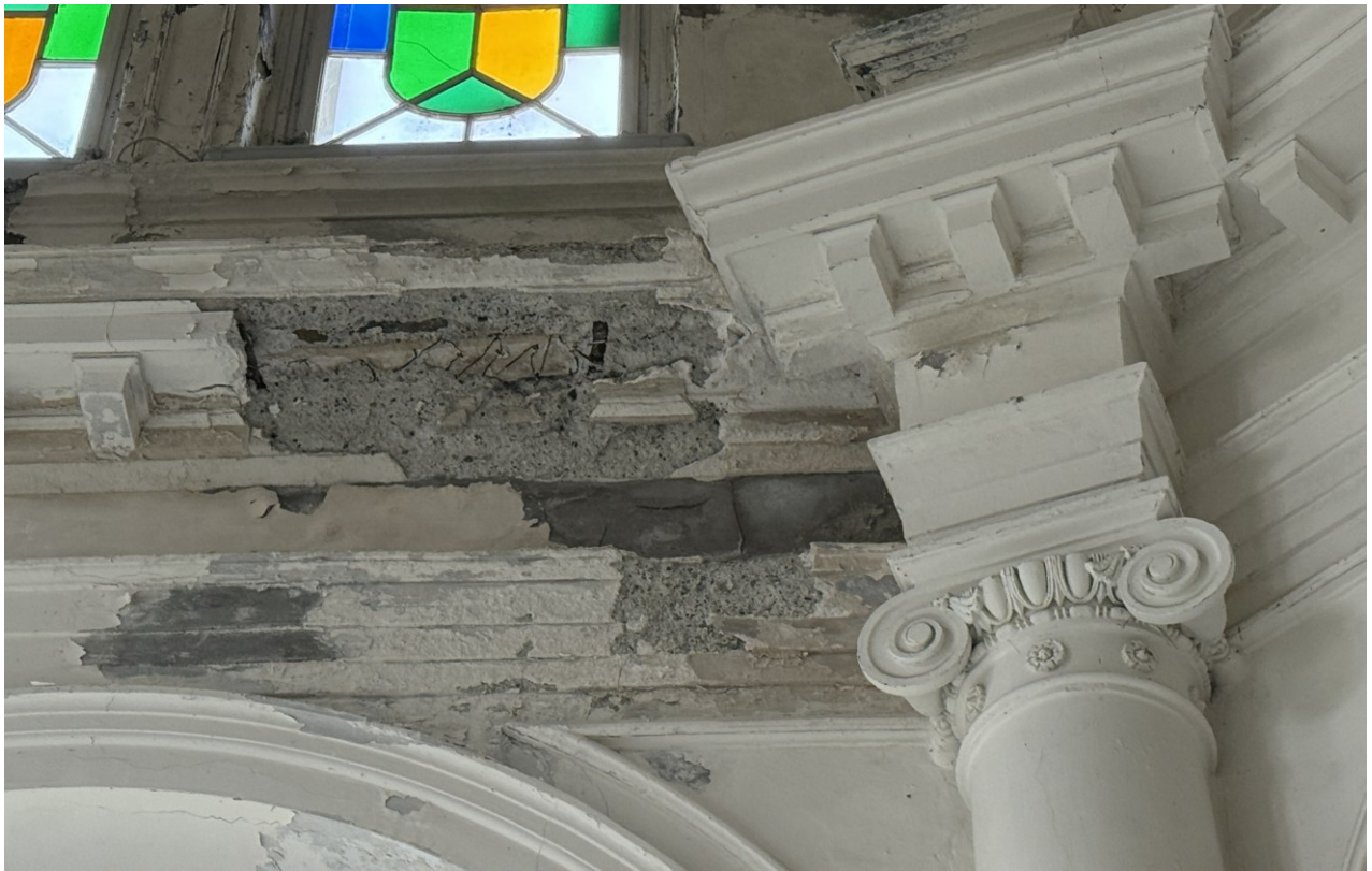
Abb. 6: Detail des beschädigten Frieses: unter dem Fenster ist ein Holzbalken sichtbar
