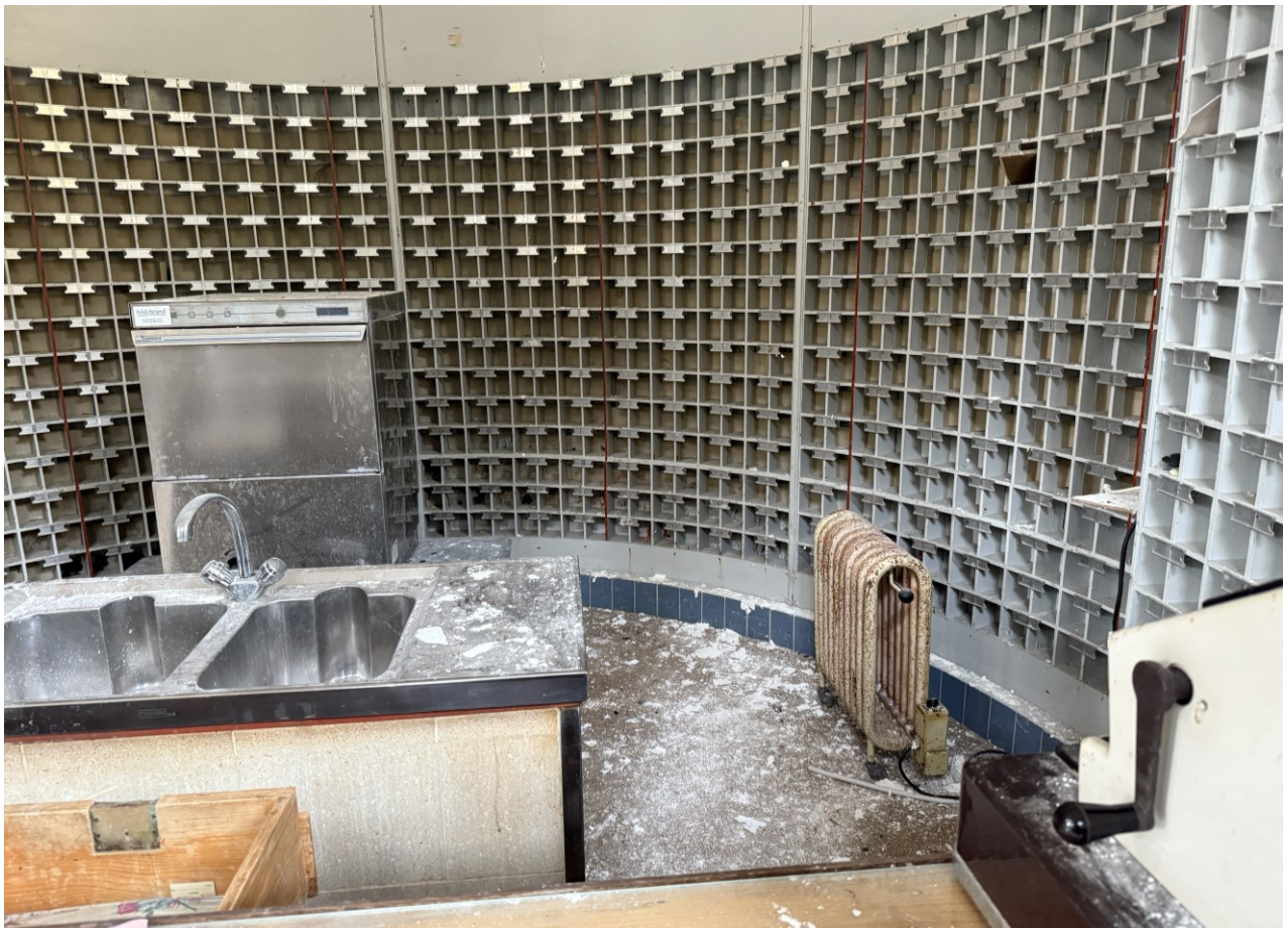
Abb. 10: Herab gefallene Verputzteile
