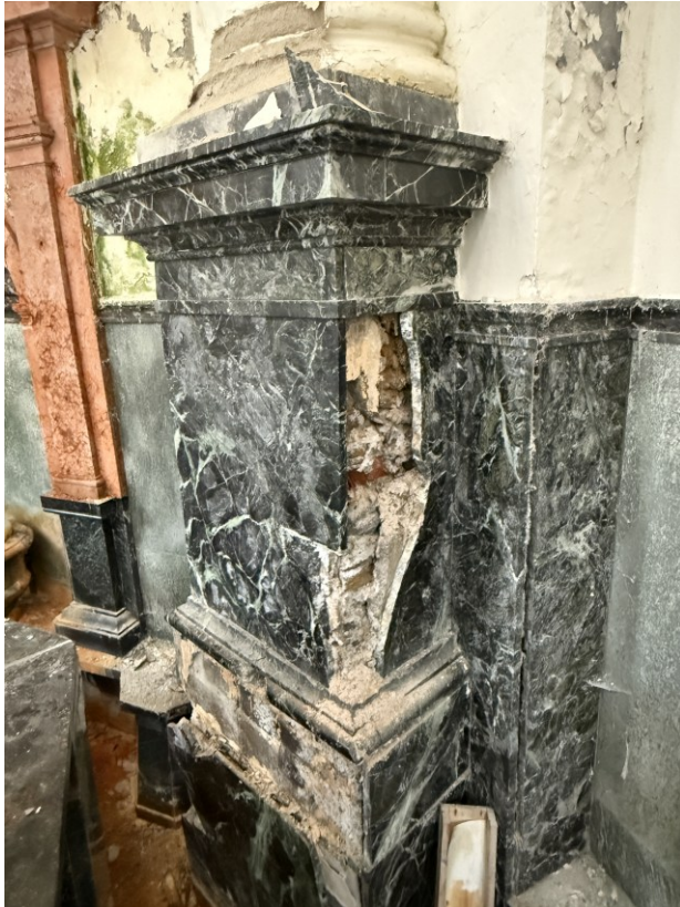
Abb. 9: Zersetzter Fugenmörtel und Lockerung von Mauersteinen
