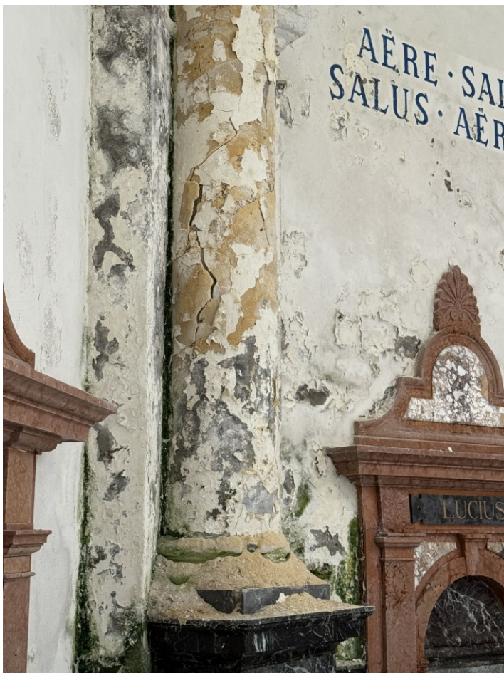
Abb. 7: Aufgrund von Frostschäden aufplatzende Säule mit Staubansammlung aus gerissenen Bruchstellen
