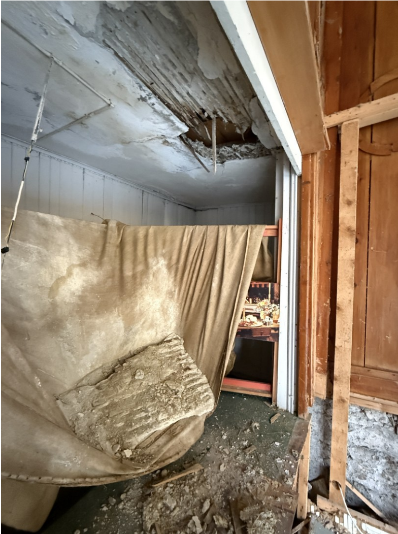
Abb. 11: Heruntergefallenes flächiges Teil einer verputzten Holzlattendecke
