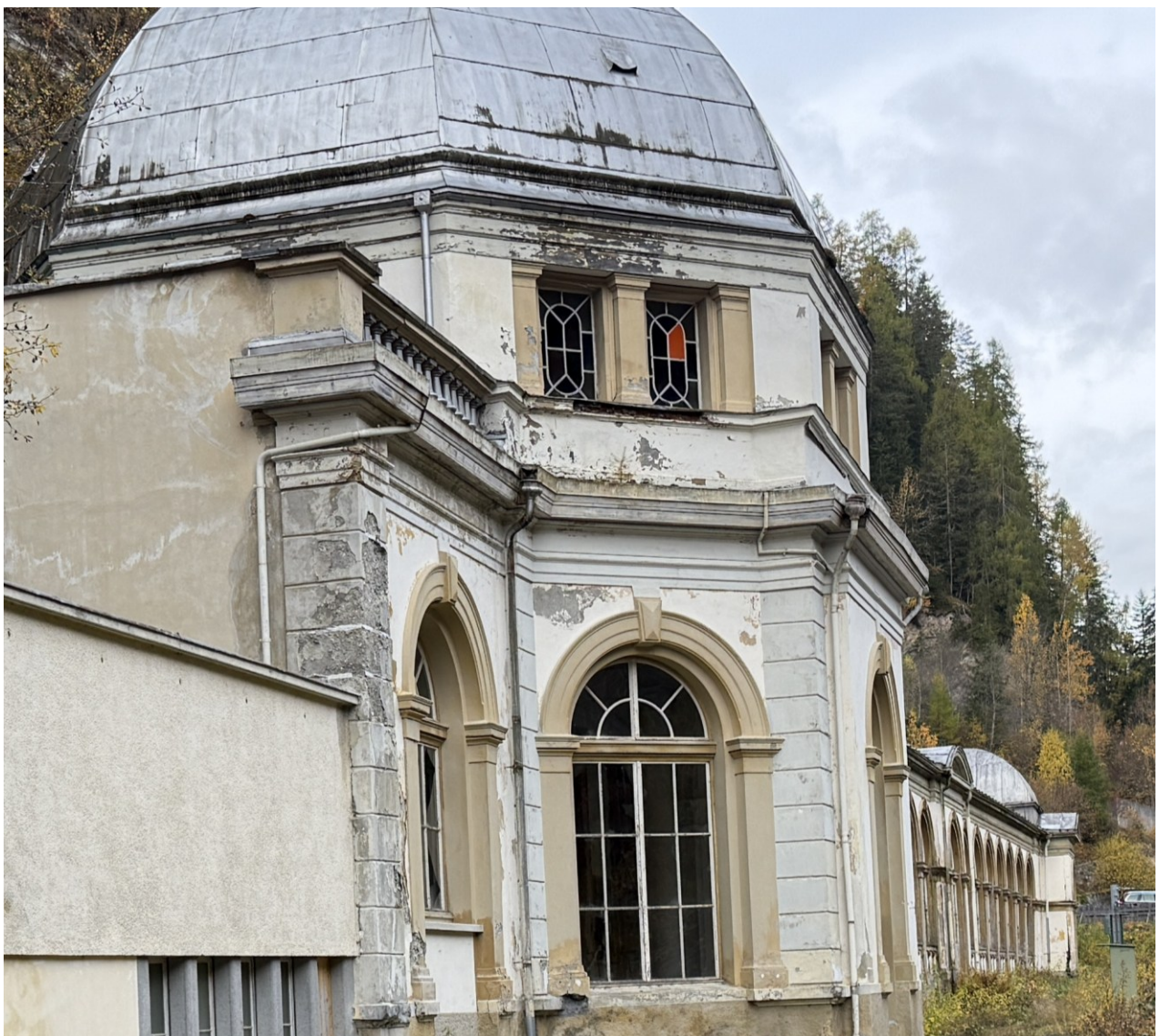
Abb. 2: Spuren eindringender Nässe: abfallender Verputz, zerstörte gemörtelte Eckquader, fehlender Fensterbank
