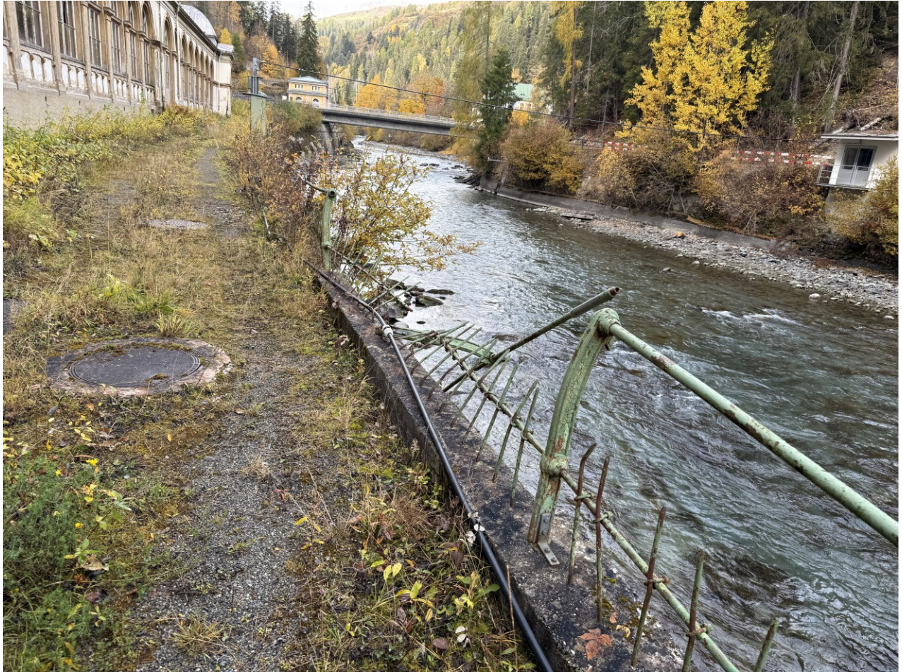
Abb. 3: Zustand des Geländers entlang der Ufermauer
