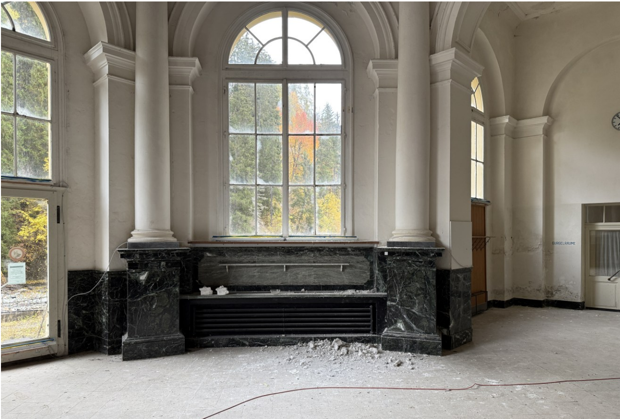
Abb. 5: ...die Trümmer der herabgefallenen Stuckaturen
