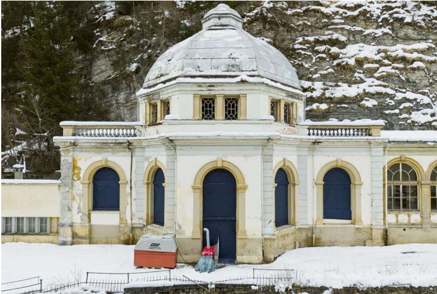
Apparats technics pro l'entrada i'l stabilimaint istoric: Ün dischümidifichader ed ün s-chodamaint dessan retardar la decadenza da la Büvetta Tarasp.
